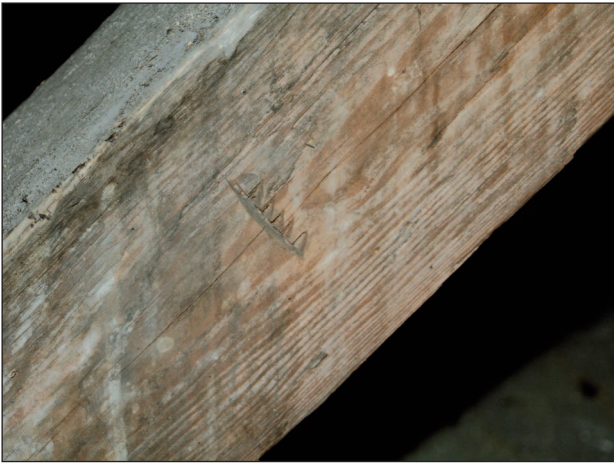
16. Bóżnica w Fordonie, więźba dachowa, ciesielski znak montażowy tzw. pilasty, wiązlar piąty, 2008 r.; fot. A. Jankowski 16. The synagogue in Fordon, the rafter framing, the carpenter's mounting sign, so-called sawtooth, fifth roof truss, 2008; photo A. Jankowski
