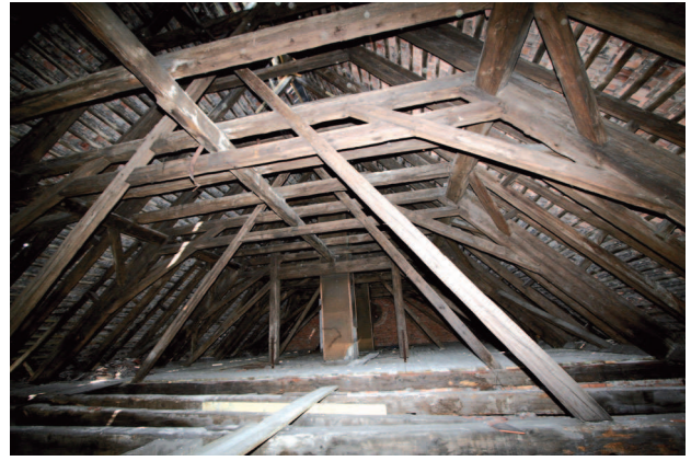
13. Bóżnica w Fordonie, więźba dachowa, 2008 r.; fot. A. Jankowski 13. The synagogue in Fordon, the rafter framing, 2008; photo A. Jankowski
