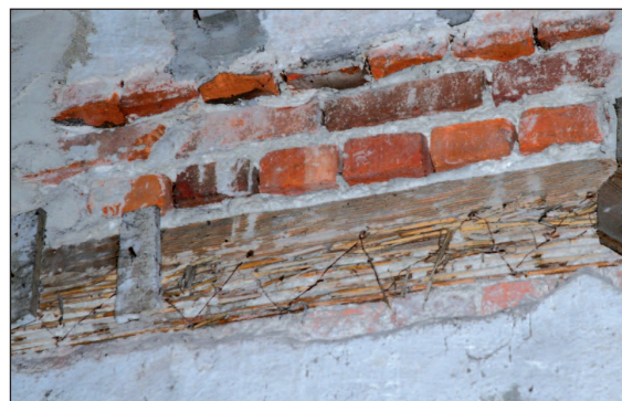
10. Bóżnica w Fordonie, wewnątrz, ściana pn. pierwotnej sali modlitw, widoczna belka podciągu dawnej empy, 2008; fot. A. Jankowski
