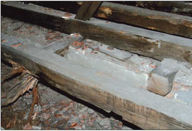
11. Bóżnica w Fordonie, wewnątrz, pierwotne podciąganie belek stropowych babińca (jeden uszkodzony, drugi obcięty), 2008 r.; fot. A. Jankowski 11. The synagogue in Fordon, the interior, original binding joists of the women's gallery (damaged and cut out), 2008; photo A. Jankowski
