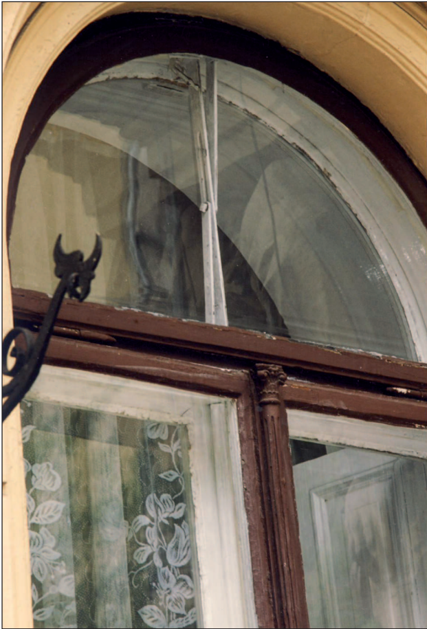
35. Okucia okna w kamienicy przy ul. Mokotowskiej 57. Fot. J. Roguska 2003
