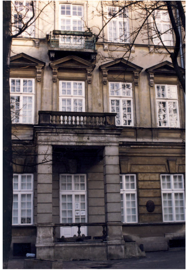
27. Pałac Belina-Brzozowskich przy ul. Brackiej 20 w głębi posesji. Fragment elewacji. Fot. J. Roguska 2003
