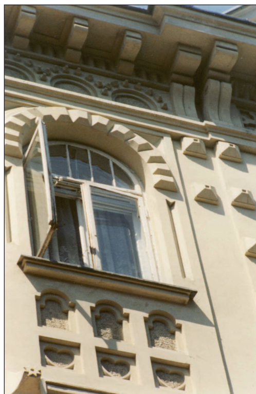
6. Okno kamienicy przy ul. Chmielnej 30, stan w 1998 r. po zmianie kolorystyki na białą. Fot. A. Żytek
