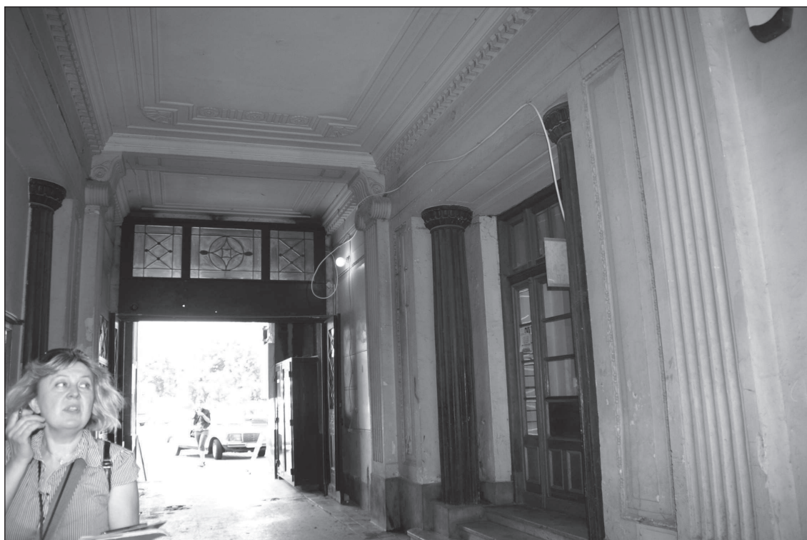
39. Warszawa, Aleje Jerozolimskie 49, kamienica, przejazd bramny. Fot. Autorka 2009 39. Warsaw, 49 Aleje Jerozolimskie, tenement house, gate passage. Photo: Author 2009
