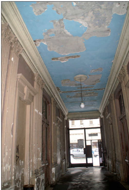
19. Warszawa, ul. Krucza 13, kamienica, przejazd bramny. Pod tynkiem przekrycia przejazdu zarysowują się belki żelazne sklepień odcinkowych. Fot. Autorka 2010 19. Warsaw, 13 Krucza, tenement house, gate passage, iron beams of the sprung-arch roof under the plaster of the gate roof- ing. Photo: Author, 2010
